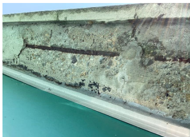
屋上 パラペット下端鉄筋暴露
