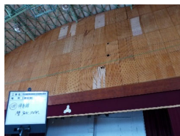
屋内運動場 壁材剥離
