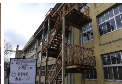
鉄骨階段 発錆、腐食
