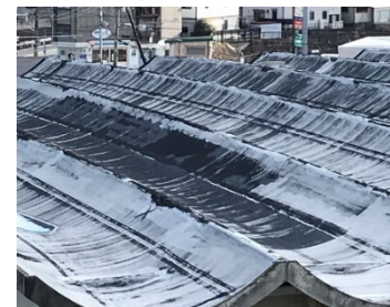
体育館屋根防水剥離劣化、浮き、 雨水堆積
