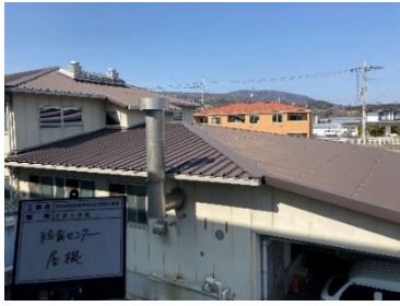
屋根劣化状況
