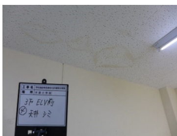
天井 雨漏り痕
