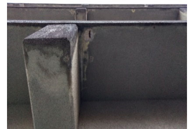
軒天井コンクリート欠損、鉄筋暴露
