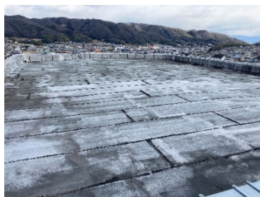
屋上防水劣化、目地亀裂多数
