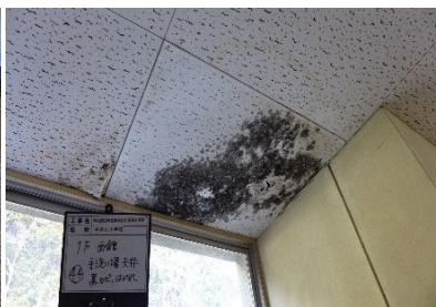
天井 漏水痕、腐食
