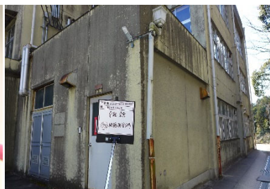
外壁亀裂、変色劣化、縦樋腐食分断
