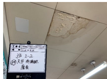
天井 雨漏り痕腐食
