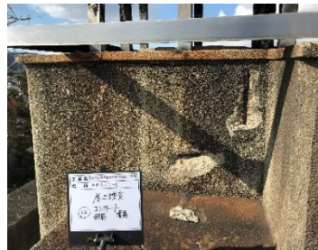
屋上 煙突コンクリート欠損 鉄筋暴露
