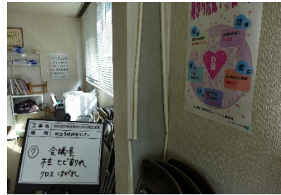
柱亀裂、壁紙剥離
