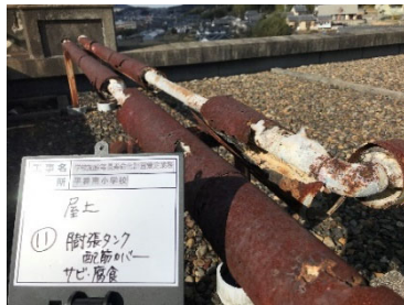
屋上 膨張タンク配管カバー 発錆、腐食
