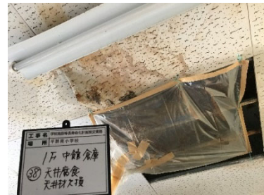
天井 腐食破損
