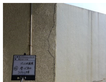
プール付属室 壁亀裂
