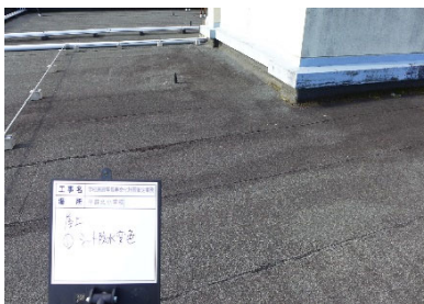
屋上 防水変色劣化
