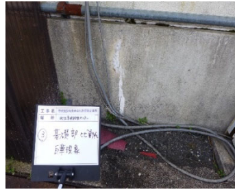
基礎部亀裂、白華現象
