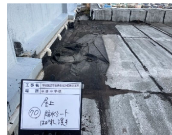
補修防水層剥離、浮き
