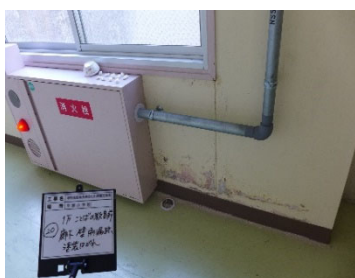
壁 雨漏り痕、塗装剥離変色
