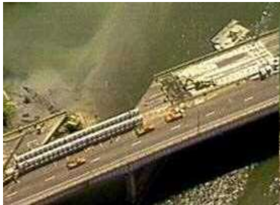
写真-1 マイアナス橋の落橋
