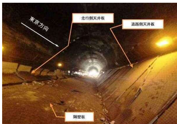
写真-3 天井板崩落状況①
