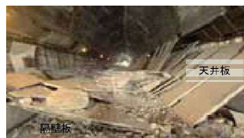
写真-4 天井板崩落状況②
